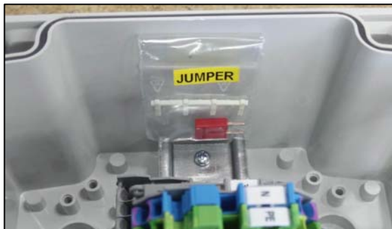
Перемычка и заглушка в электроустановочной коробке
